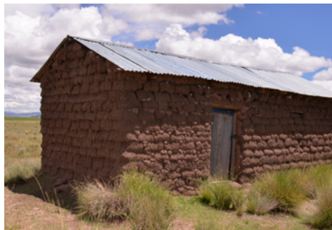
図8 屋根に穴が空いた小屋
